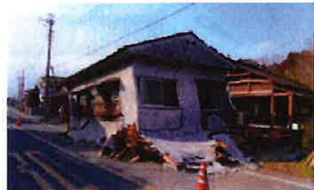
揺れによる被害
